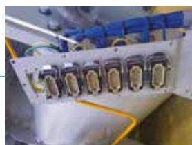
■ Высоковольтный распределительный шкаф
