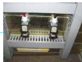
■ Подстанция коробчатого типа
